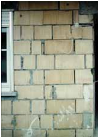
offene Fugen, nicht vollflächig vermauert, zu geringes Überbindemaß
