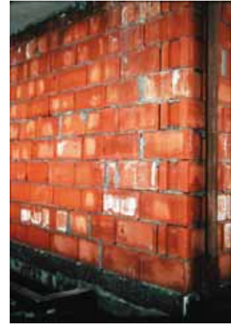
Kritisches Mauerwerk: Offene Fugen, Mörteltaschen, durchnässt
