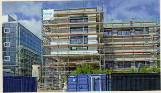
1 Der zeitliche Rahmen für die Arbeiten im neuen Universitätsgebäude in Koblenz ist eng gesteckt. Es soll möglichst bald für Forschung und Lehre bereitstehen.
