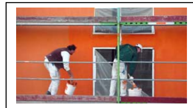
Bildzeile: Farbenfrohe Ästhetik: Für den Anstrich in ausdrucksstarkem Rot-Orange kam die quick-mix Fassadenfarbe LOBAXAN LX 300 zum Einsatz. Diese hoch deckende Farbe auf Siloxanbasis eignet sich insbesondere für den Einsatz auf LOBATHERM Wärmedämm-Verbundsystemen.
