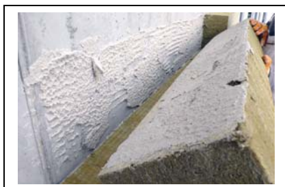
Bildzeile: Alles mit einem Material: Sowohl für das Verkleben der Mineralwolldämmplatten als auch für die Erstellung der Armierungsschicht wurde der quick-mix Klebe- und Spachtelmörtel „SKS leicht“ verwendet.
